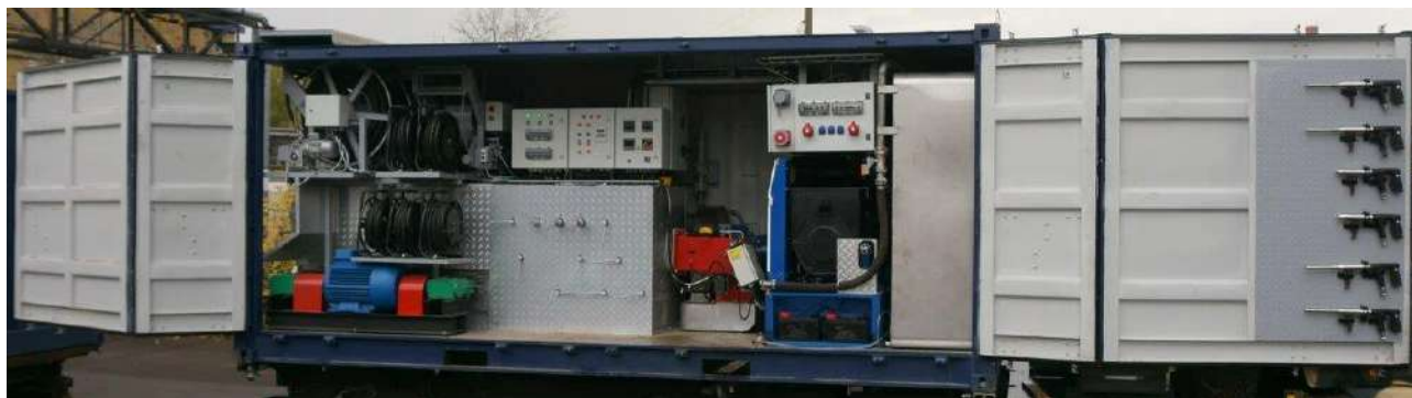
Рисунок 4 - Общий вид энергетического блока КМПК
