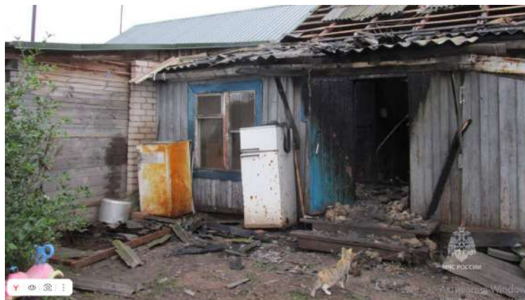
Рисунок 5 – последствия пожара в частном жилом доме в Оренбуржье
