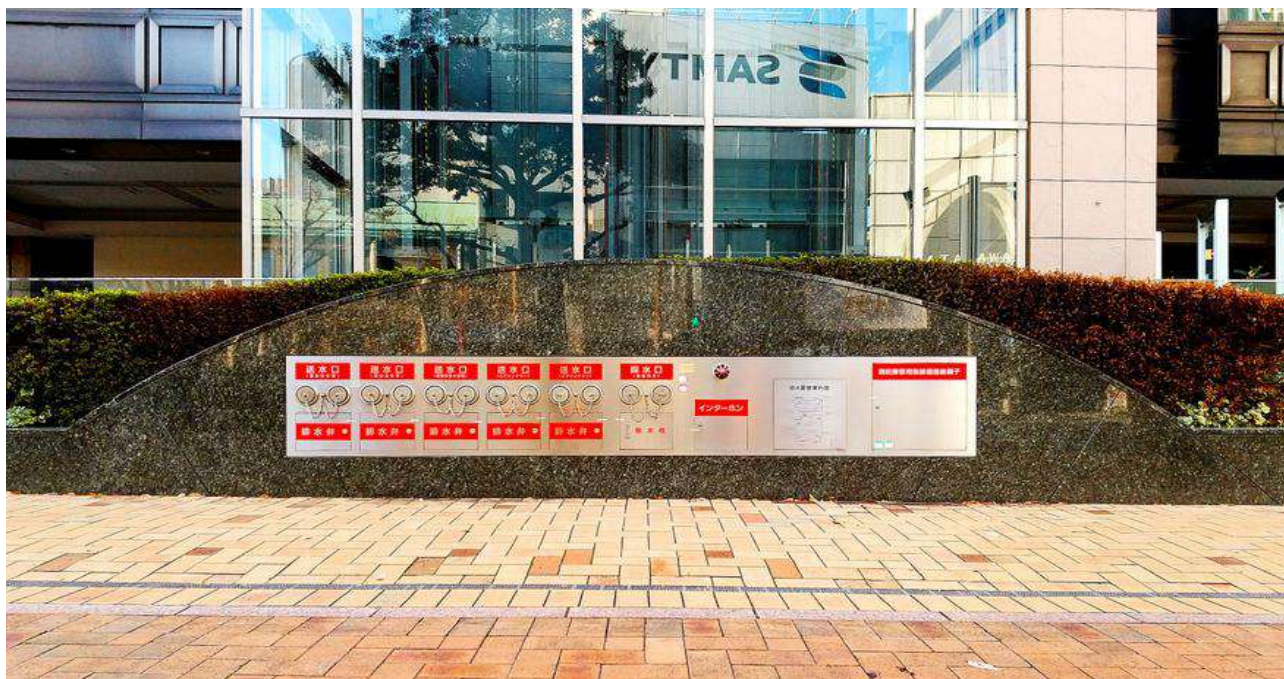
Рисунок 2 – Места подключения к пожарным стоякам
