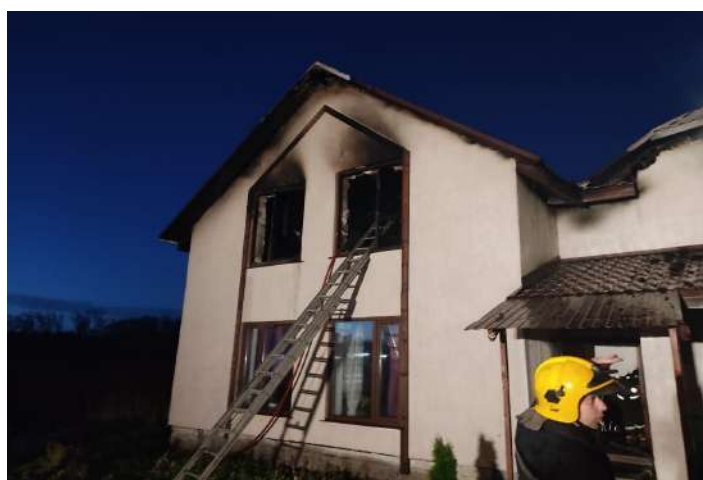
Рисунок 2 – последствия пожара в частном жилом доме
